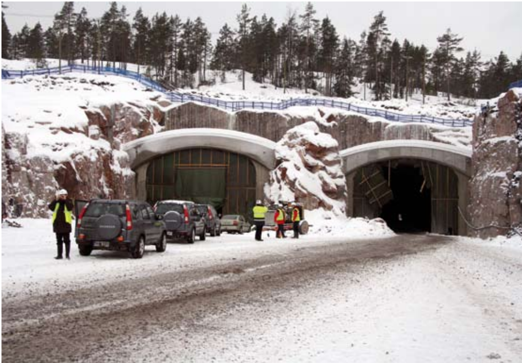
Uuden ykköstien Lohja-Muurla -osuudelle tulee seitsemän kaksoistunnelia. Yksi niistä on tämä 480 metrin pituinen Lakiamäen jo työmaaliikenteelle avattu tunneli lähellä Muurlaa.
